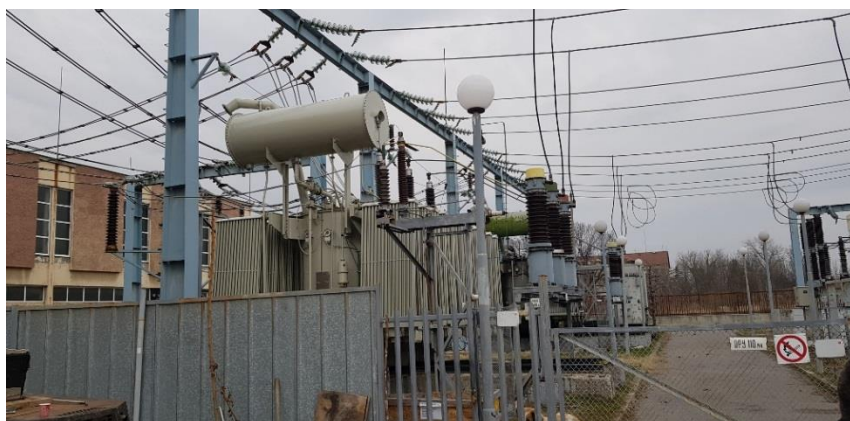
Фигура 4: Трансформатори и 110 kV част на ПС Орион
