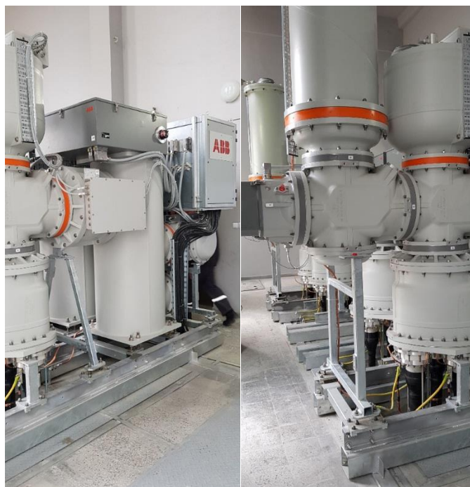
Фигура 2: Подстанция Витоша 110 kV закрыта част
